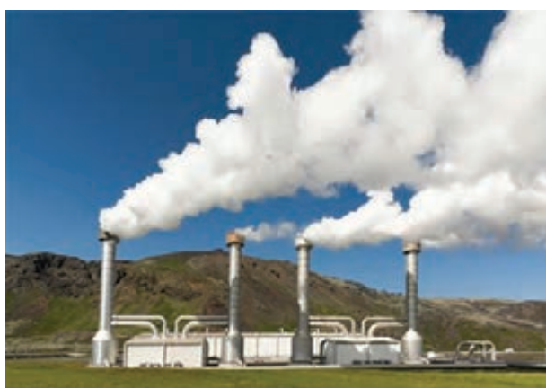
شکل ۱۱-۴- نیروگاه زمین گرمایی مشکین شهر - اردبیل
